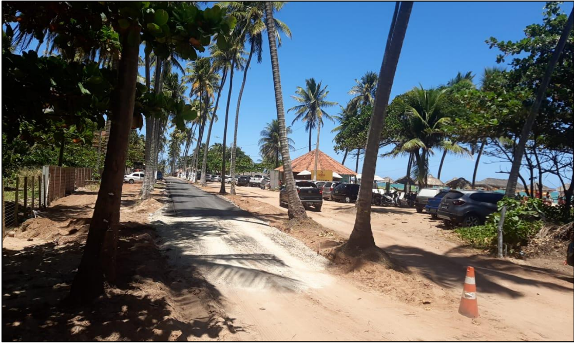
FOTO 5: OBRAS DE INTERVENÇÃO NA ORLA DA PRAIA DE GUAXUMA EM DESCONFORMIDADE COM A IMPLEMENTAÇÃO DO PGI
